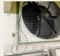
Ofte kan man genbruge de eksisterende elinstallationer
