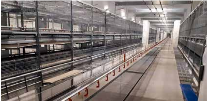
Anlægget med etagesystemet Natura Primus til hønnikeopdræt kort før de første fugle sættes ind
