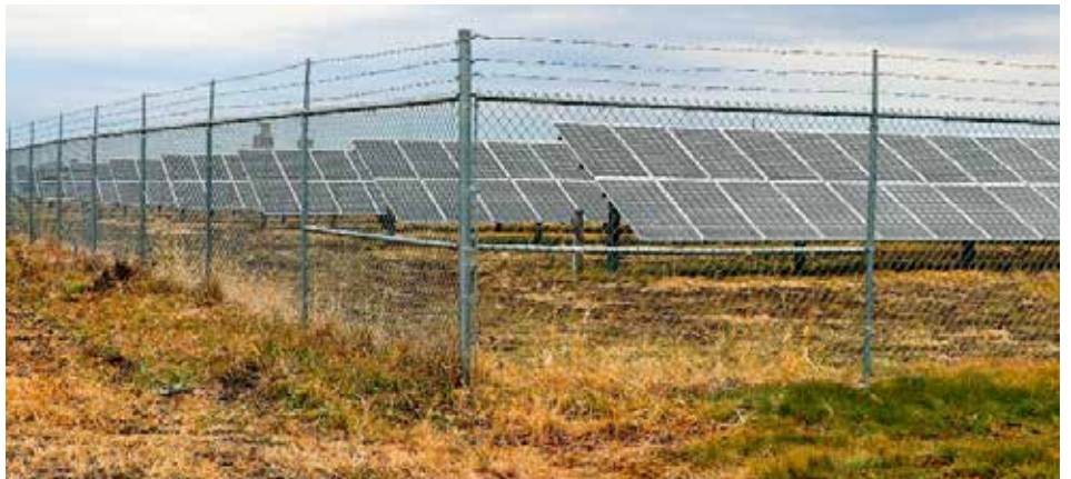
Det store solcelleanlæg på marken på 9 acres blev bygget i 2016 for at levere elektricitet til virksomhedens ægpakkeri, distributionsanlæg, køleanlæg og kontorer. Foto: Deven Kin
